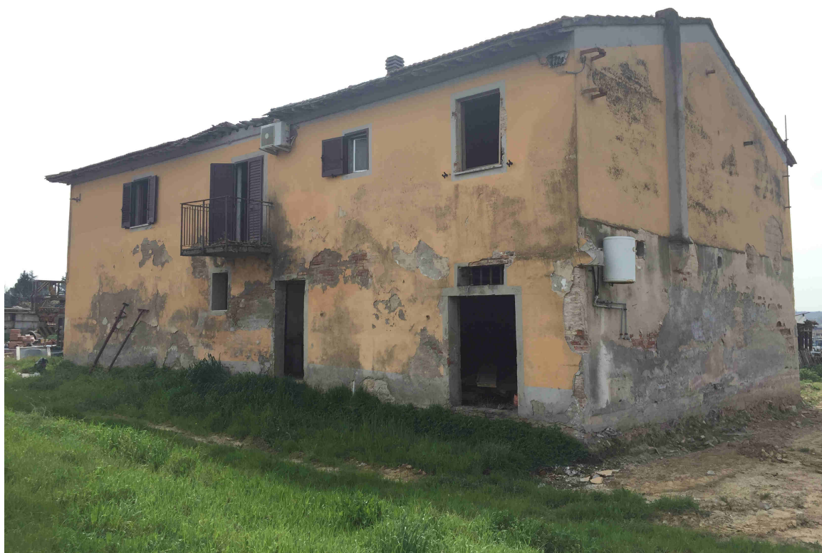
Foto n.2 – Presa fotografica dell'immobile soggetto a piano di recupero – Schedato al n.62 – prospetto est-nord
